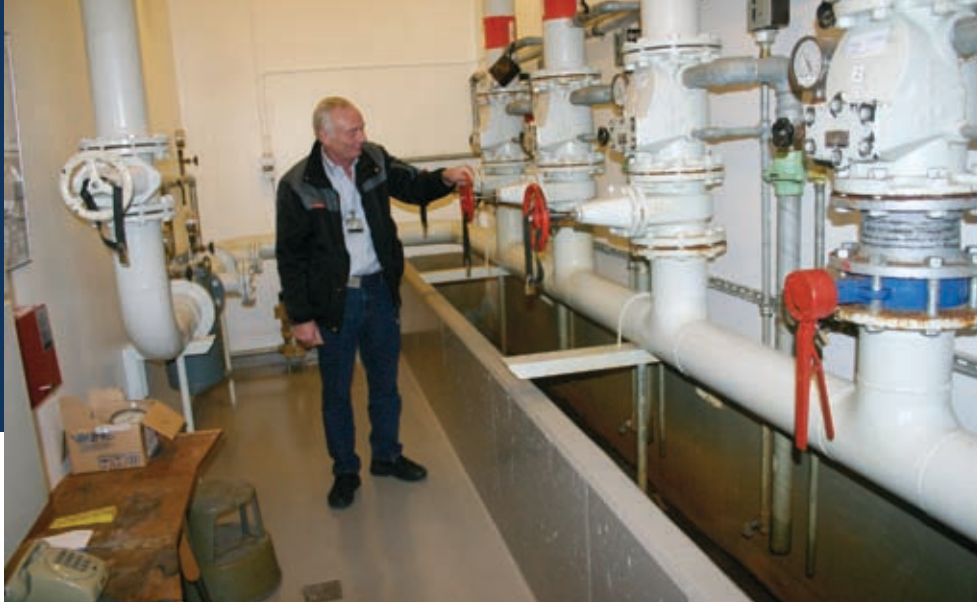
Fra dette rum styres bygningernes sprinkler-anlæg, der skal afprøves jævnligt.
